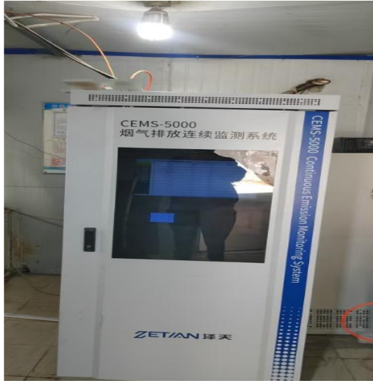
烟气排放连续监测系统
