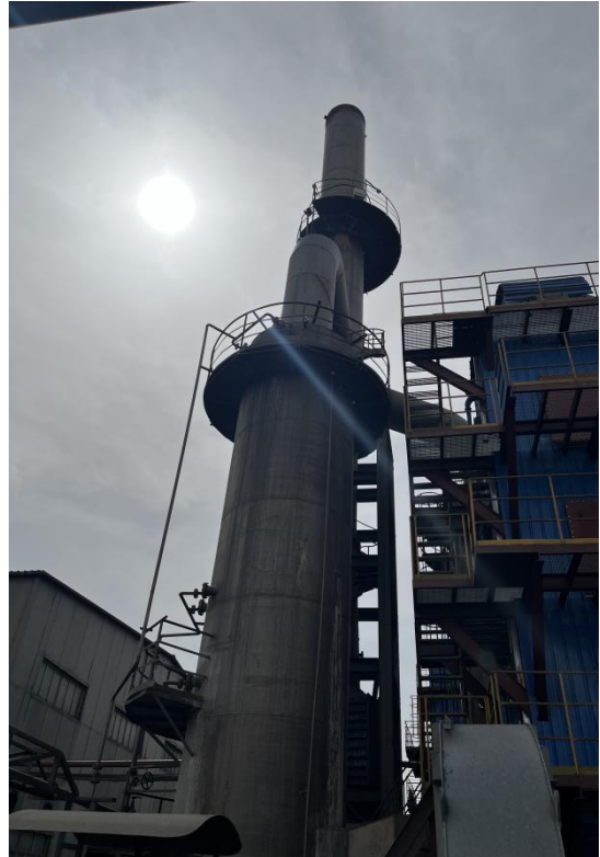
尾气锅炉排口
