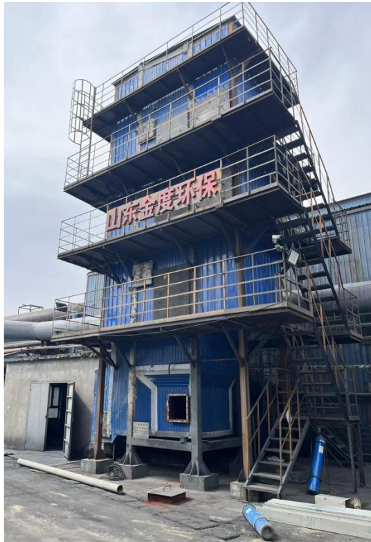
项目脱硝工程
