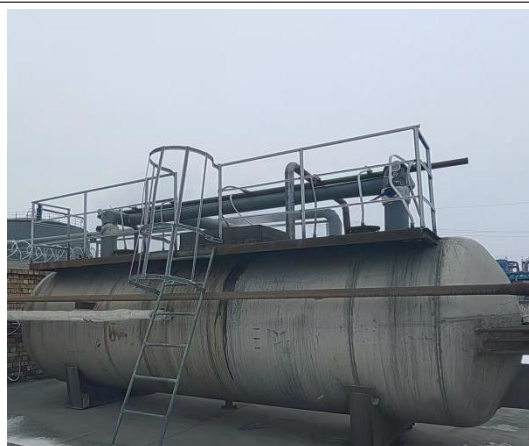
罐区呼吸气收集装置
